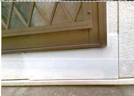
外壁のはがれ ボードを貼り付けました
